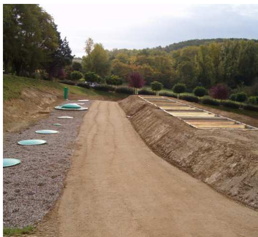
STATION 200 EH AVEC TRAITEMENT TERTIAIRE UV ET BOUE PAR ROSEAUX TONNEINS 47
