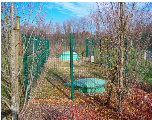
STATION 150 EH AUTOROUTE TOISIAT
